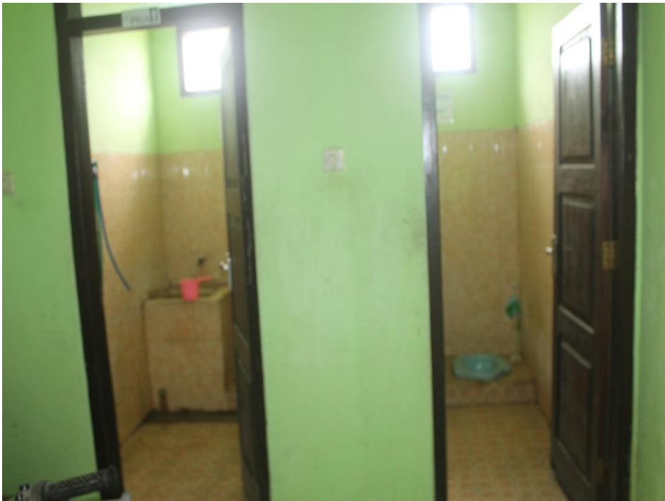
Gambar 2.12 Toilet di Kecamatan Bancar
